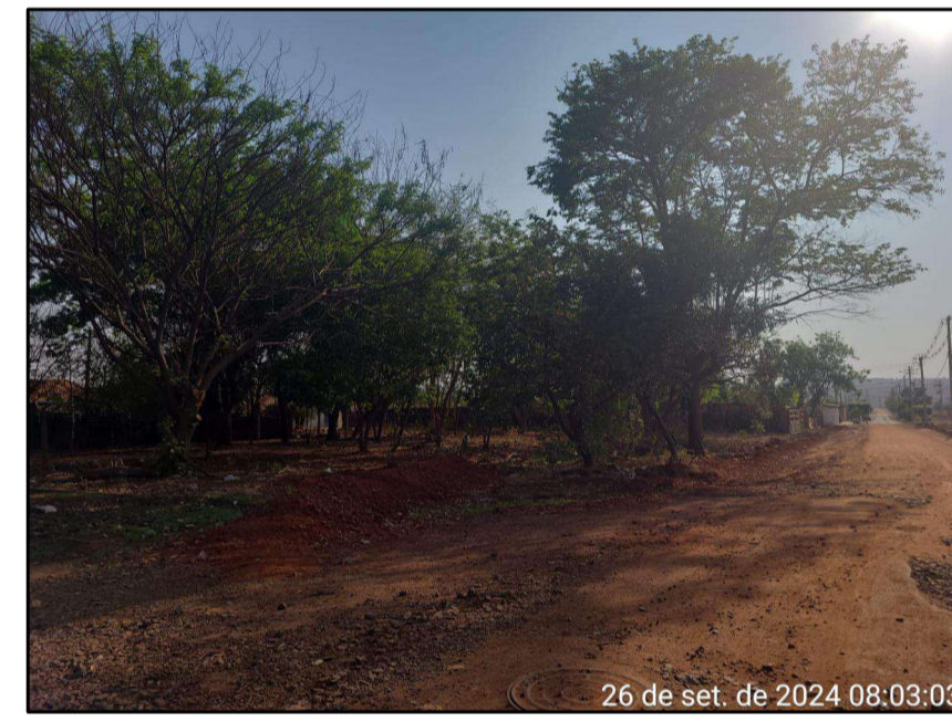
Rua Geraldo Ferreira, confluência com a Rua da Prudência. Execução de guia e sarjeta, rampa de acessibilidade, calçada e pavimentação.
