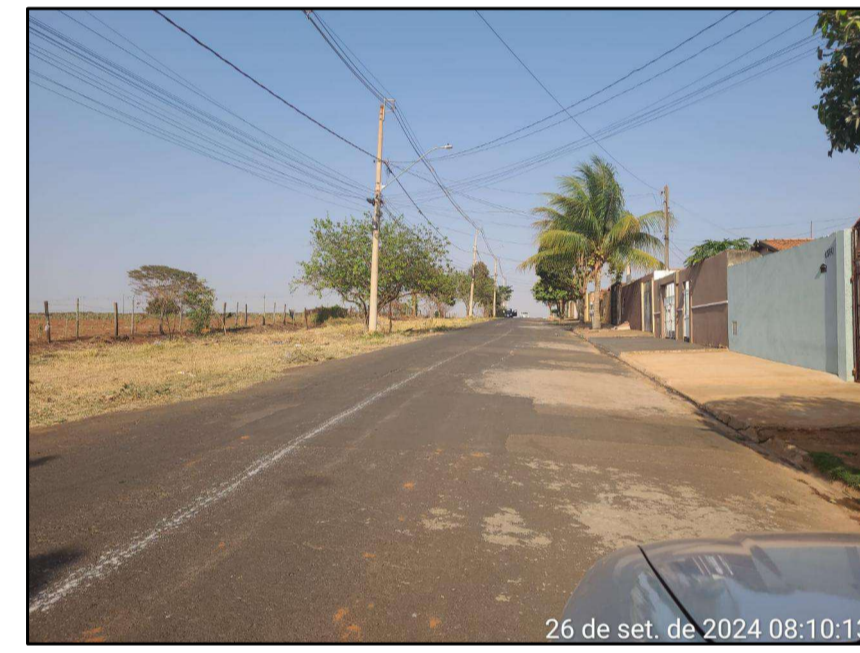
Rua Geraldo Ferreira, confluência com a Rua Aldo D'arbo. Execução de calçada.
