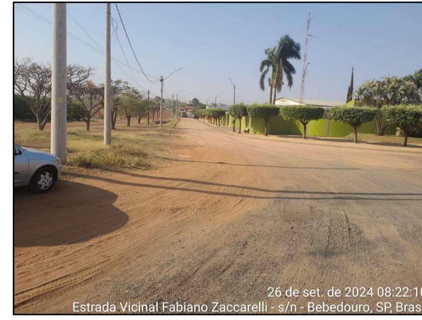
Rua Antônio Florêncio Ataíde, confluência com a Vicinal Fabiano Zaccarelli. Pavimentação e execução de guia e sarjeta.
